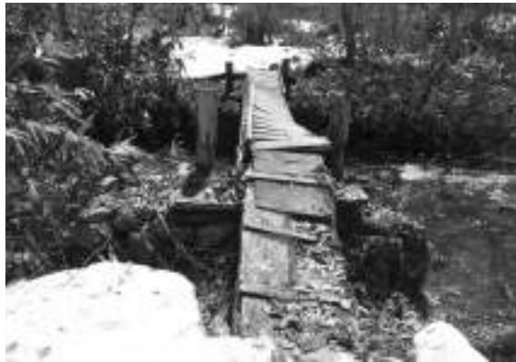
▲雪の重みで傾いた八木沢橋
