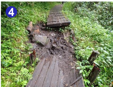
4 木道が一部、破損しているところがあります。気をつけて通過してください。
