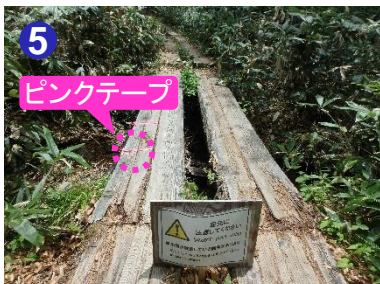
ピンクテープが結ばれている木道は破損しています。避けてお通りください。
