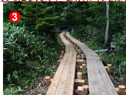
3 富士見田代の木道工事が進んでいます。滑り止めゴムも付くようです。
